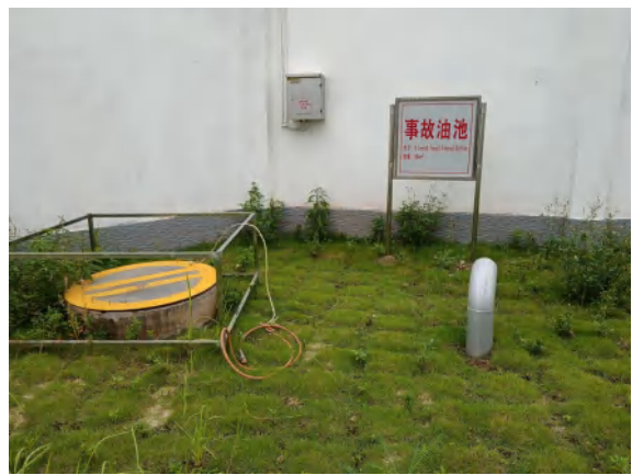
站内事故油池
