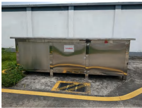
站内一体化污水处理设备
