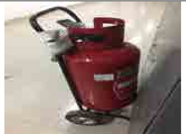
项目内部消防设施
