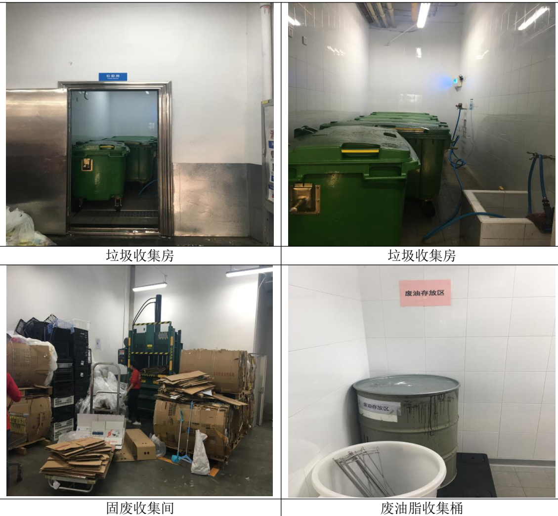
图 4-4 固废处理设施
