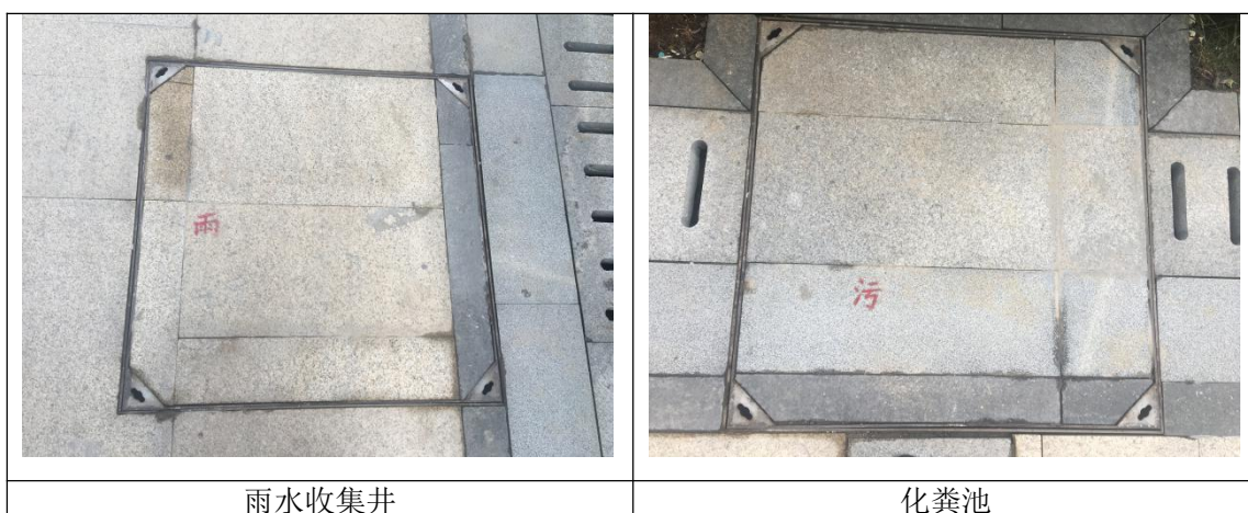
图4-2 污水处理设施
