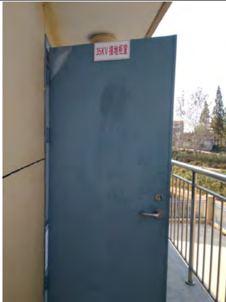
35KV 接地柜室
