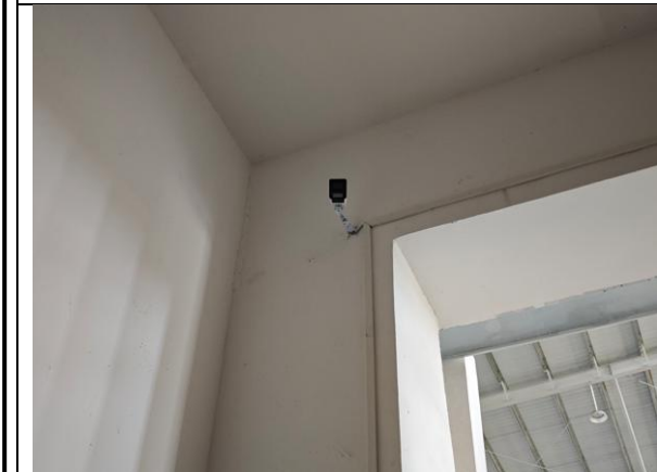
探伤室内摄像头
