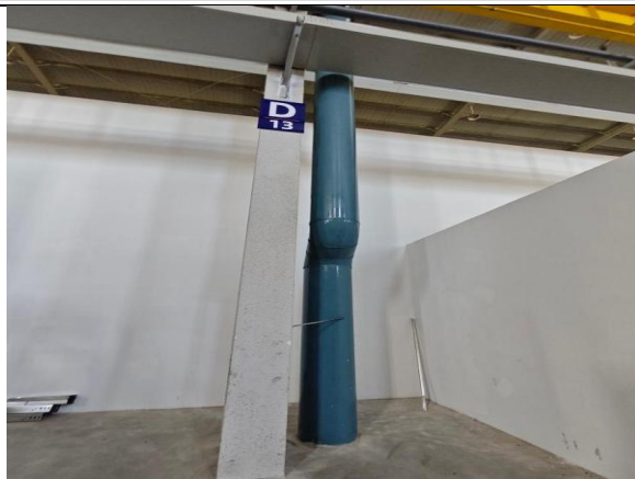
探伤室排风管
