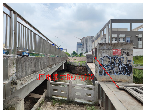
电缆线路跨越河涌
