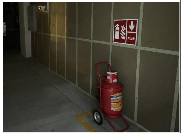
站内消防设施
