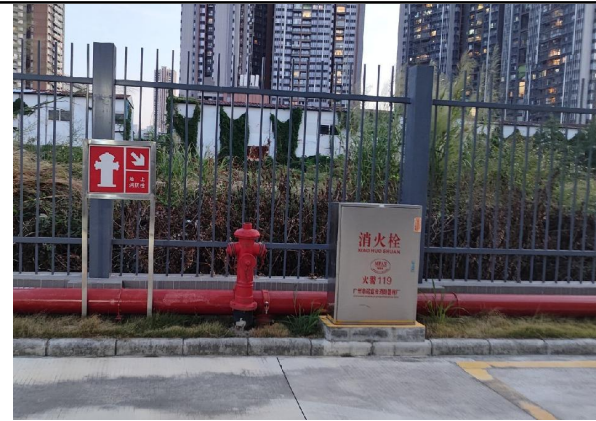
站内消防设施
