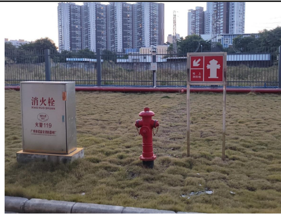
站内消防设施
