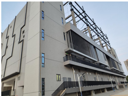
220kV 出线间隔
