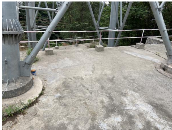
塔基采用方位不等高腿铁塔 (龙头山森林公园内 220kV 橄碧线#15)
