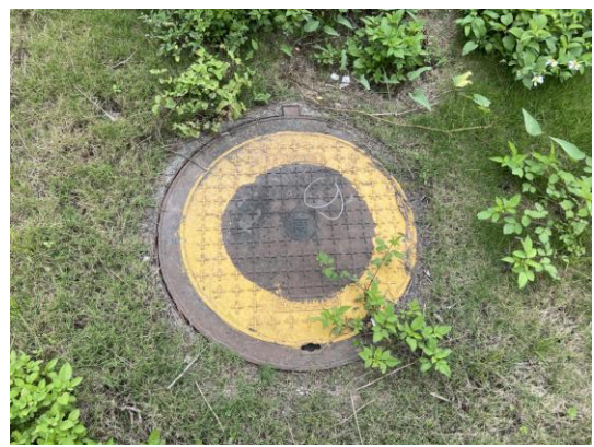
站内雨水井盖
