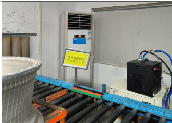
空调通风系统
