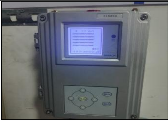
RL5000 型固定式场所辐射探测报警装置显示器
