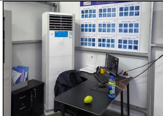
空调通风系统
