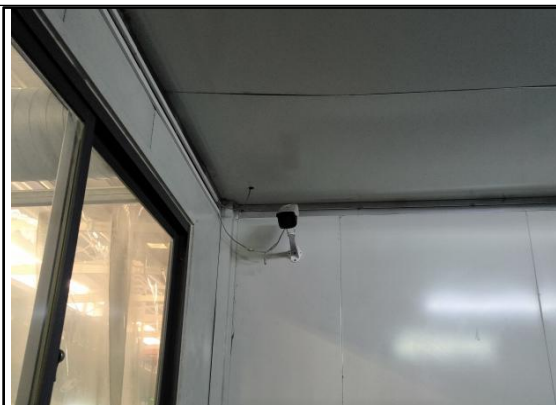
检测室内视频监控
