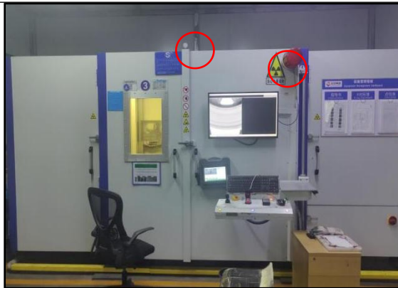
3#DU320W 型 X 光机电离辐射警告标志、RL5000 型固定式场所辐射探测报警装置探头
