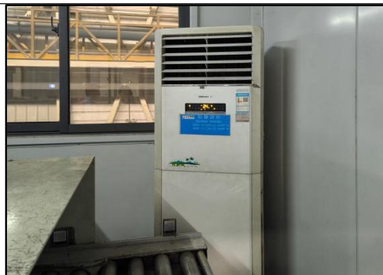
空调通风系统
