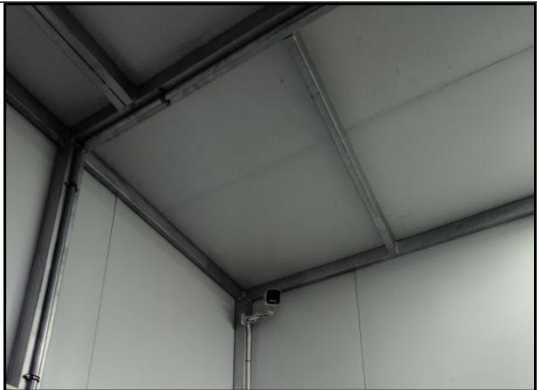
检测室内视频监控
