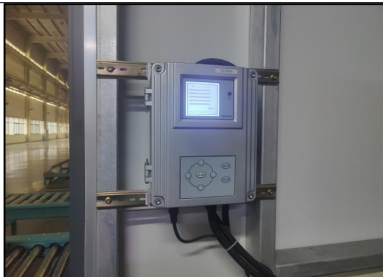
RL5000 型固定式场所辐射探测报警装置显示器
