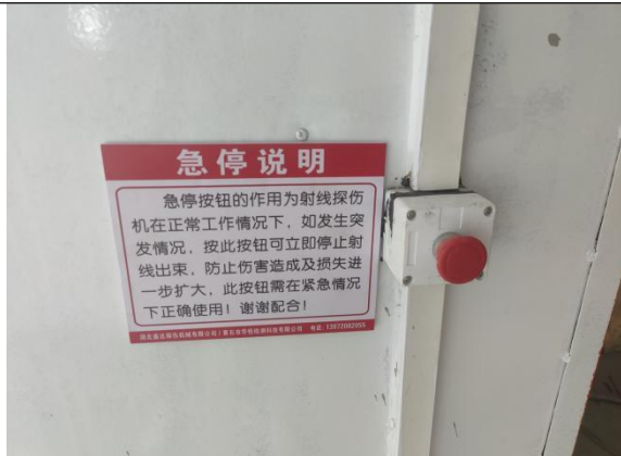
探伤室内紧急停机按钮
