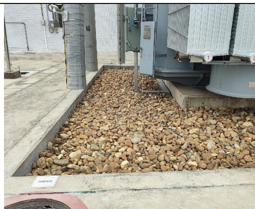
新建主变下方集油坑
