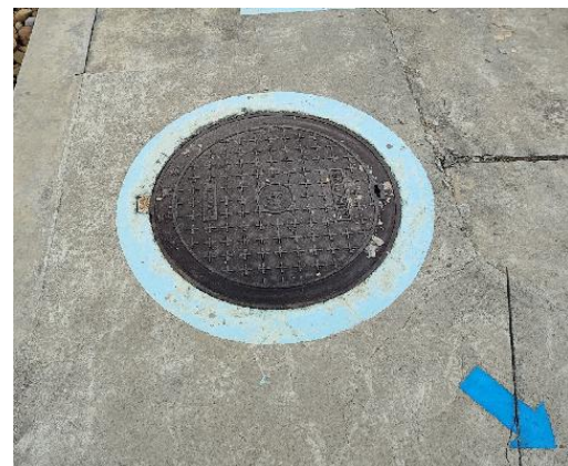
变电站雨水井
