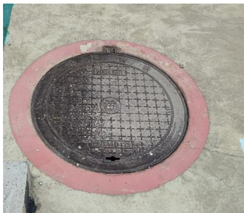
变电站污水井
