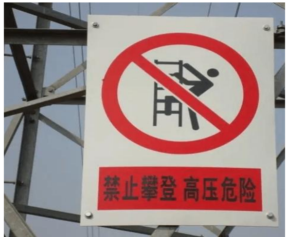
杆塔塔身警示标志
