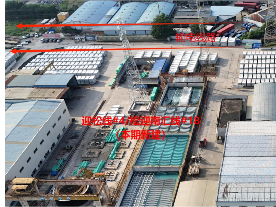
输电线路（新建杆塔周边）
