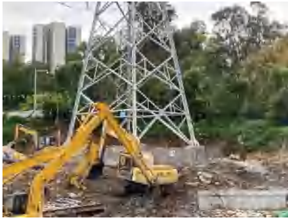
220kV 金乌甲乙线 1#塔基下方植被恢复（因天然气管道施工，绿化未能完全恢复）
