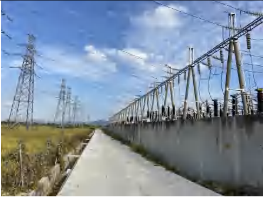
图 2-3 白塔 220kV 变电站间隔扩建侧现场照片
