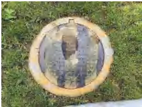
站内污水井盖
