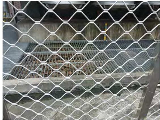
本期#3 主变下方集油坑
