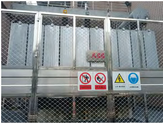
本期#3 主变 (1×63MVA)
