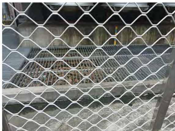
主变下鹅卵石及集油坑
