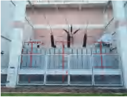
原有#2 主变 (1×240MVA)
