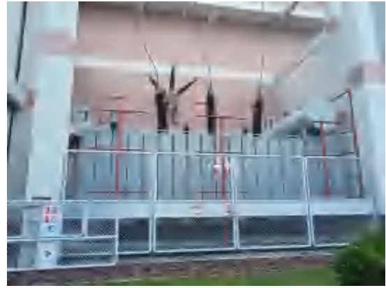
原有#3 主变 (1×240MVA)
