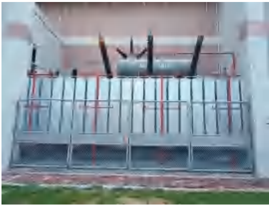
本期扩建#1 主变 (1×240MVA)
