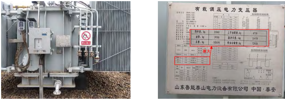
图 7-3 升压站主变铭牌
