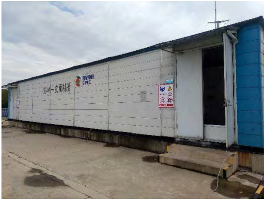
35kV 设备预制舱
