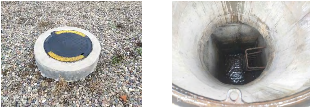
图 7-4 协鑫 110kV 升压站站內事故油池照片
