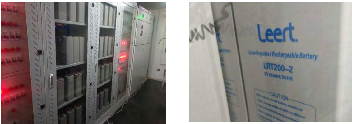
图 7-1 协鑫 110kV 升压站站内铅酸蓄电池照片
