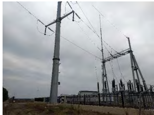
110kV 配电装置区
