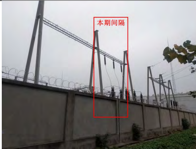
图 1-5 黄罗岗 110kV 变电站 110kV 出线间隔现状照片
