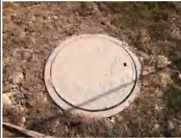
站内污水井盖
