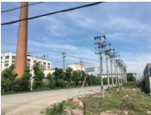
变电站南侧外环境
