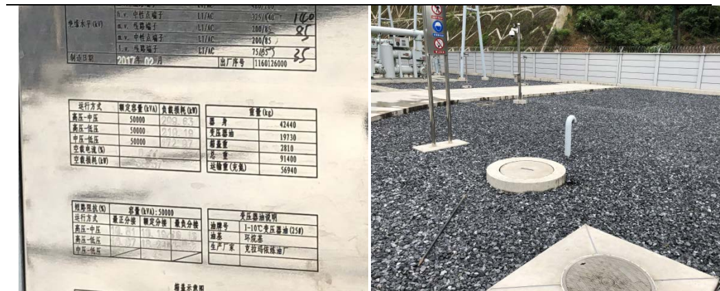
站内事故油池及主变铭牌
