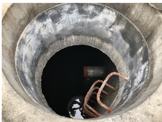
站内事故油池
