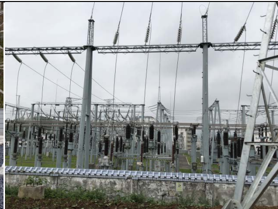
悬鼓洲变扩建间隔
