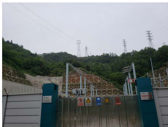
110kV 莲花变电站大门
