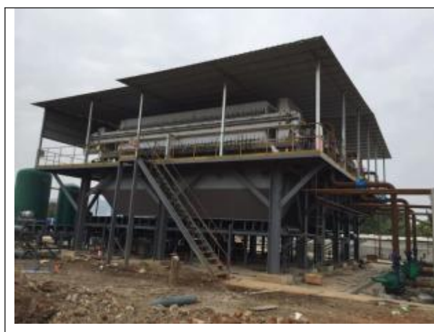
图4-8 现场固化脱水一体化系统照片
