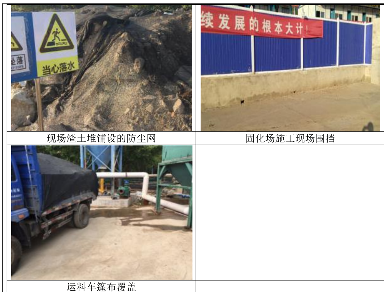
图4-15 废气治理措施照片
