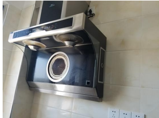
升压站内综合楼油烟净化器
