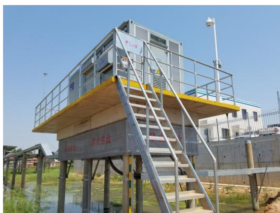
光伏场区箱变
