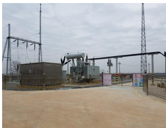
升压站内主变压器
