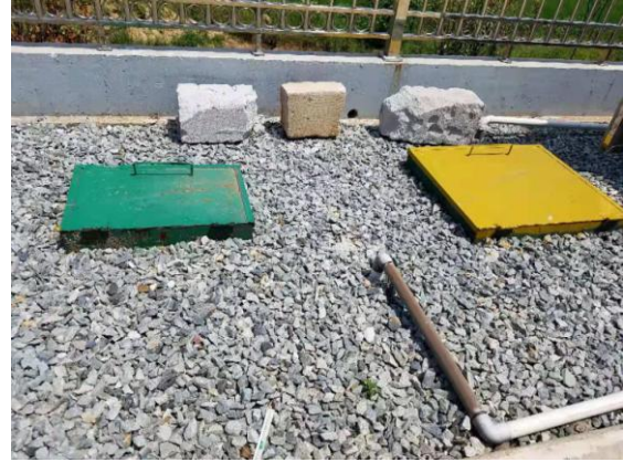
一体化污水处理设备进水口
