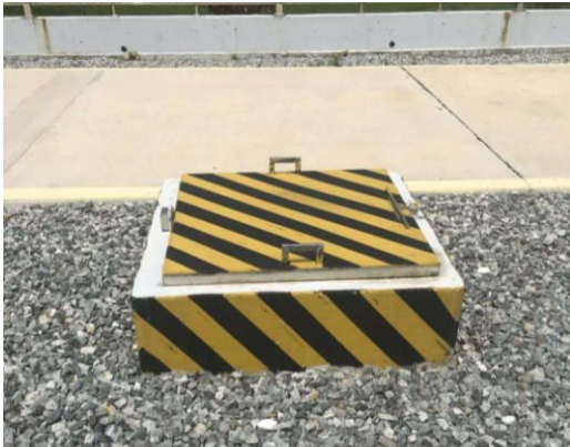
升压站内事故油池
