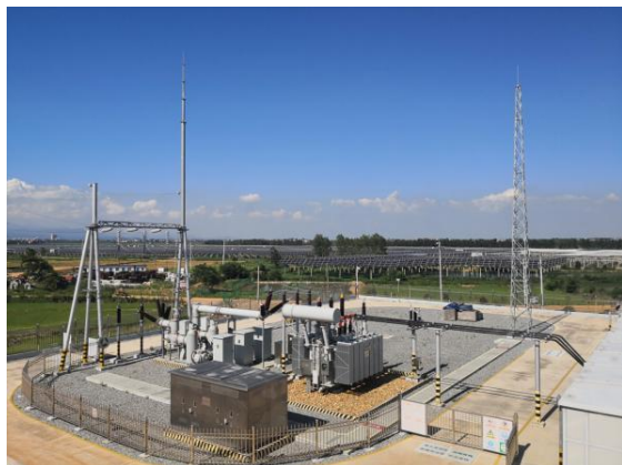
光伏场区升压站
