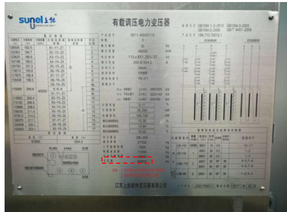
升压站内主变压器铭牌
