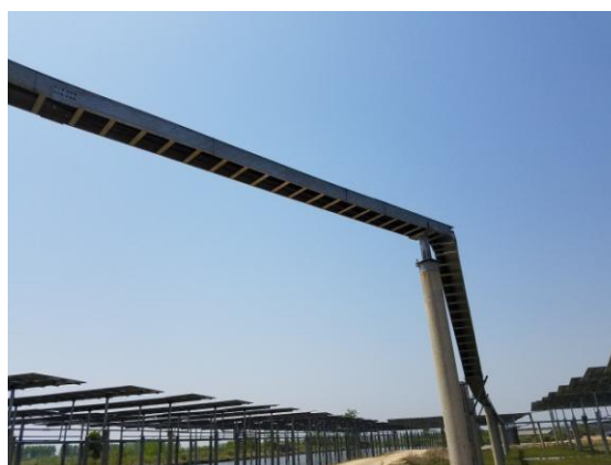
光伏场区电缆
