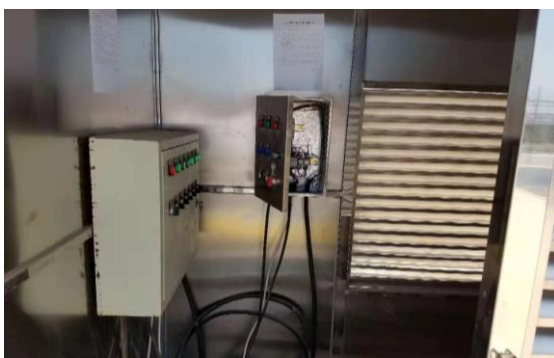
一体化污水处理设备控制室
