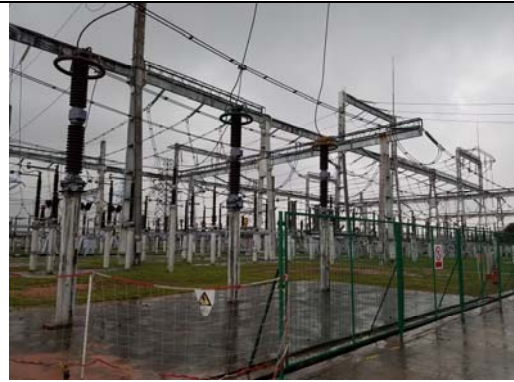
现有 220kV 户外配电装置区
